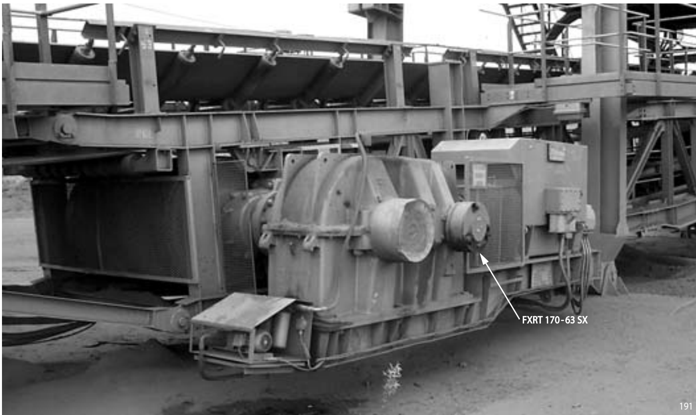
Instalación de cintas transportadoras para mineral de hierro en Sudáfrica accionadas por tres reductores con antirretrocesos FXRT 170 - 63 SX de RINGSPANN.
