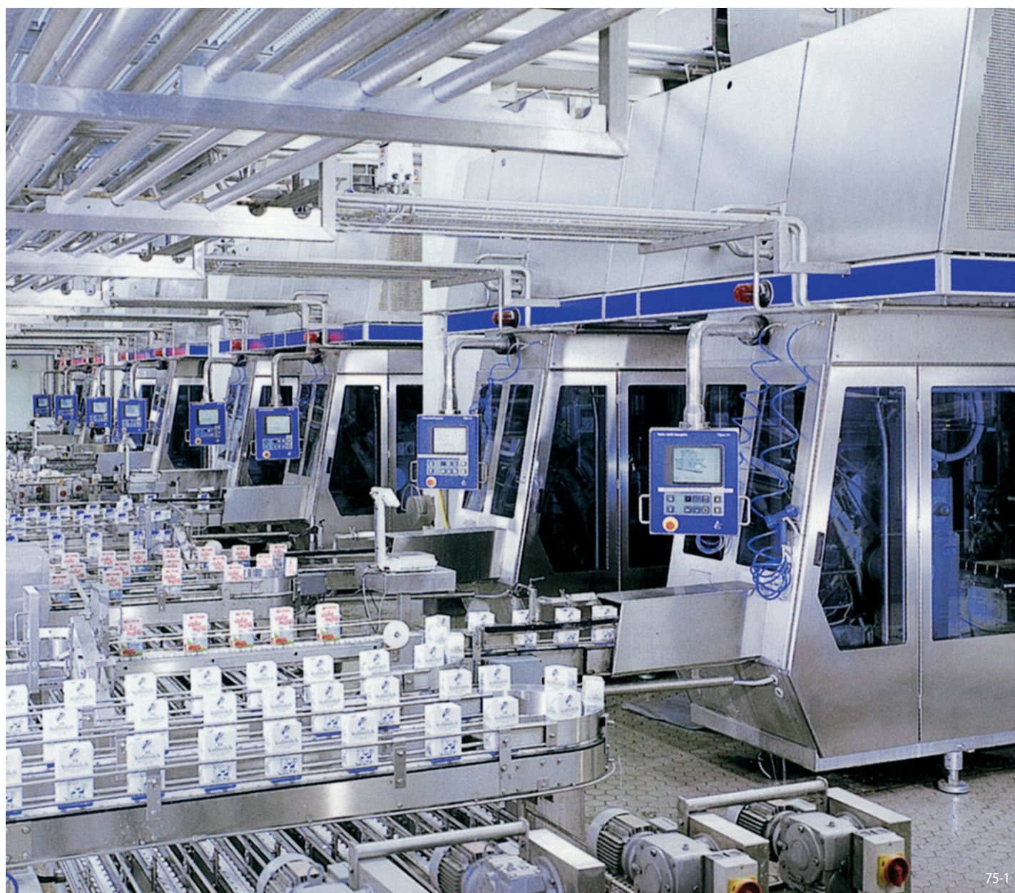
Limitadores de fuerza RINGSPANN tipo PAG, como acoplamientos de sobrecarga en una planta embotelladora.
